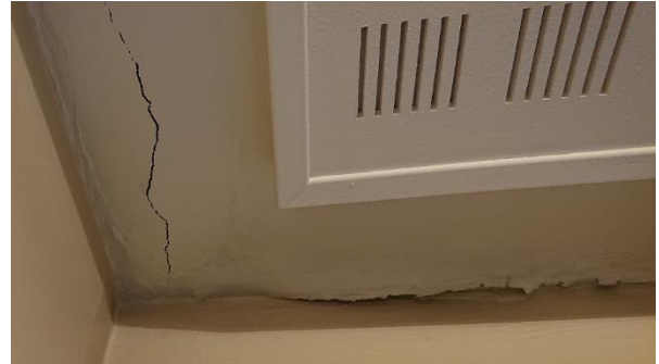
Figur 27: Fuktskader i betongdekker mot yttervegg
