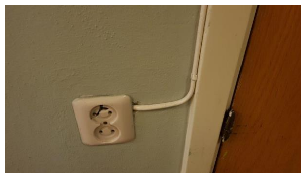
Figur 37: Generelt gammel el-installasjon, her ødelagt stikkontakt uten jording
