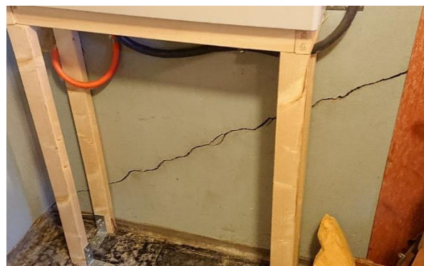
Figur 11: Setningsskade betongvegg mot traforom
