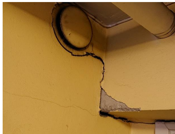
Figur 10: Setningsskade betongbjelke/-vegg mot korridor og innervegg i kjeller
