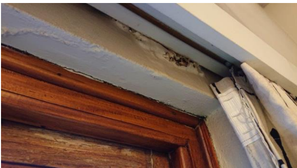
Figur 18: Fuktskader innvendig av yttervegger
