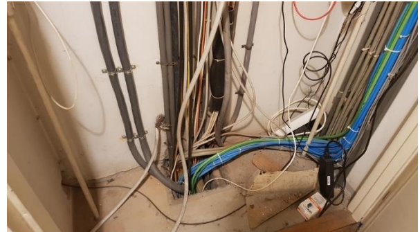
Figur 28: Mangelfull brannnetting i dekker/vegger o.a
