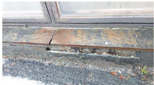
Figur 20: Skiferkledning faller av
