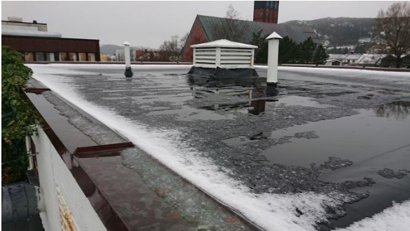
Figur 24: Eldre flate tak må renoveres/oppgraderes
