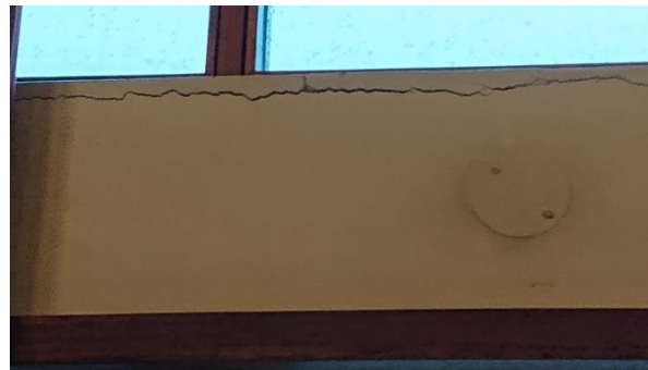
Figur 14: Sprekker/skader i betongbjelker i fasader
