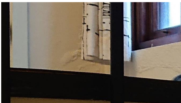
Figur 22: Fuktskader i innervegg mot yttervegg
