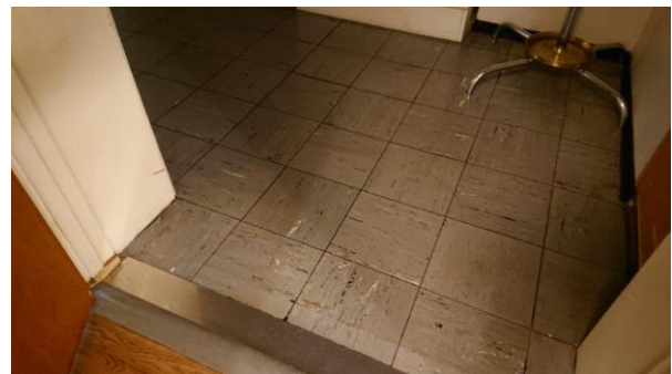
Figur 29: Gulv/himlinger/plater med mulig asbest
