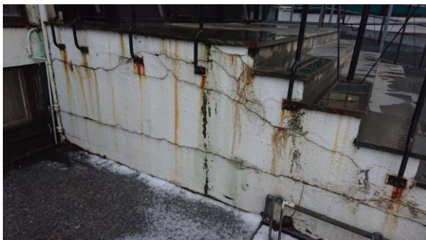
Figur 30: Trapp hovedinngang med betongvegger med betydelige skader i betong. Korrosjon rekkverk.
