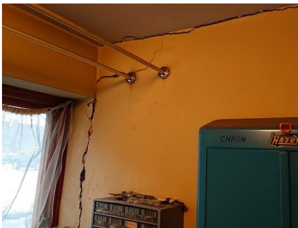
Figur 8: Setningsskade betongvegg/-dekke, mot fasade øst i kjeller
