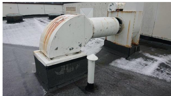
Figur 35: Enkeltrom med ny balansert ventilasjon, men kontorfløyer helt uten ventilasjon
