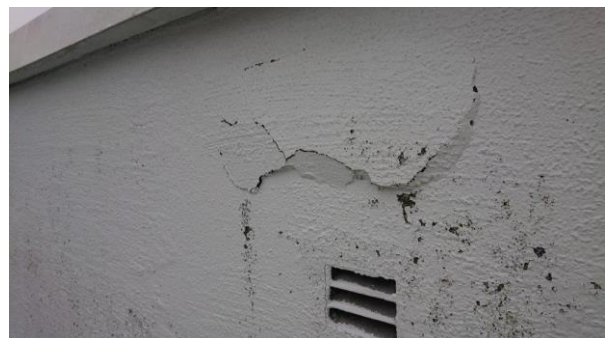
Figur 17: Armeringskorrosjon med utsprengning betong
