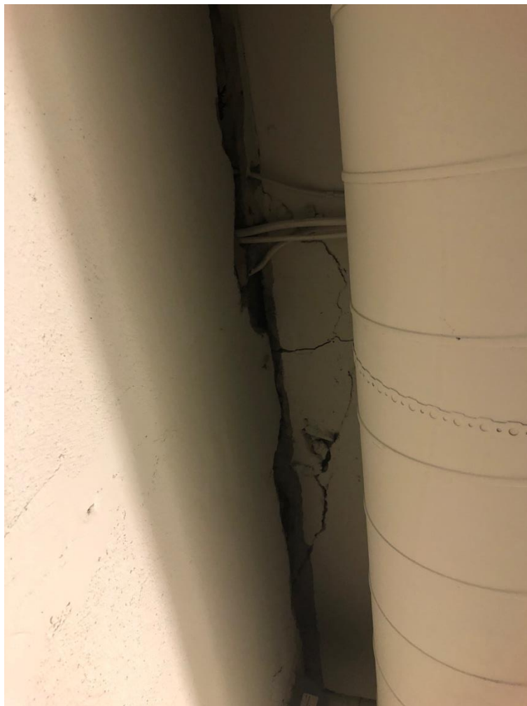
Bilde 7: Sprekker i elementdekke i kjellerkorridor pga deformasjoner (barevegg til venstre)
