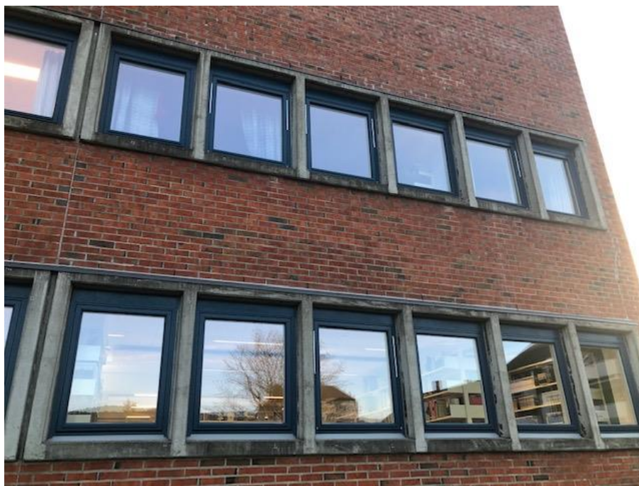
Bilde 13: Fasade vest, beslag montert på betongrammer for å hindre vanninntrengning ved slagregn
