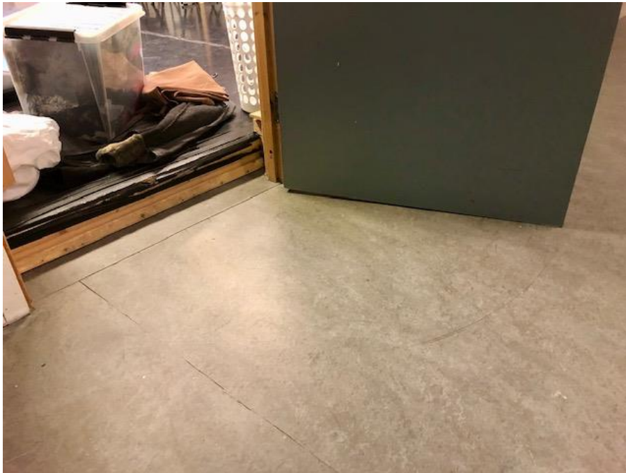
Bilde 18: Eksempel på skjev dør som subber ned i golv
