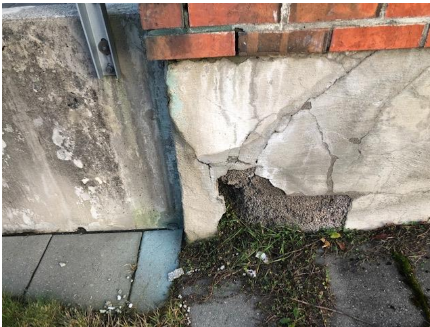
Bilde 11: Skader på lettklinkerisolasjon på grunnmur, - kan skyldes sulfatforurensing
