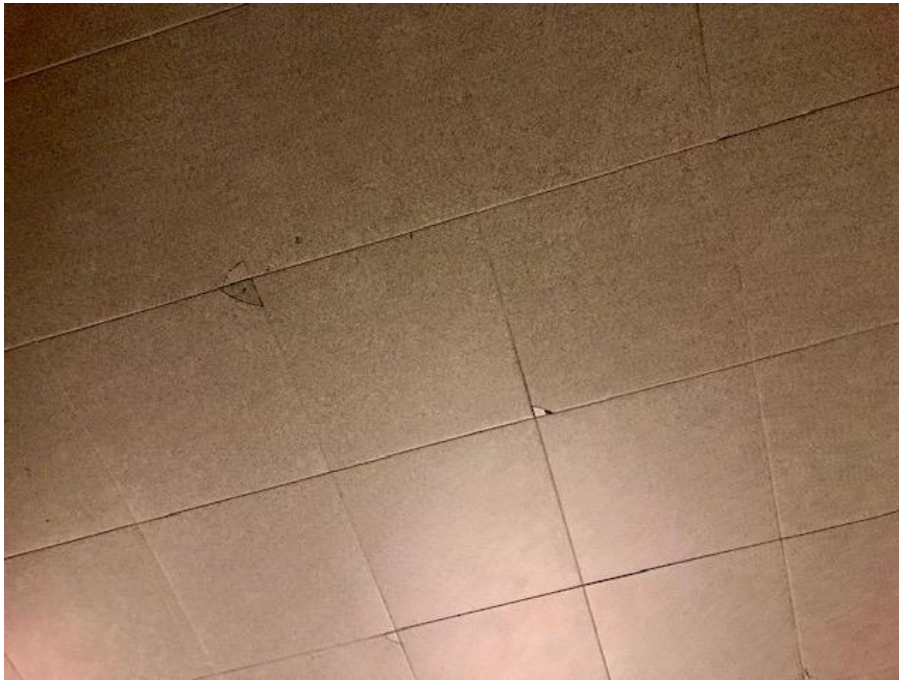
Bilde 19: Brekkasjeskader på flis i kjellerkorridor
