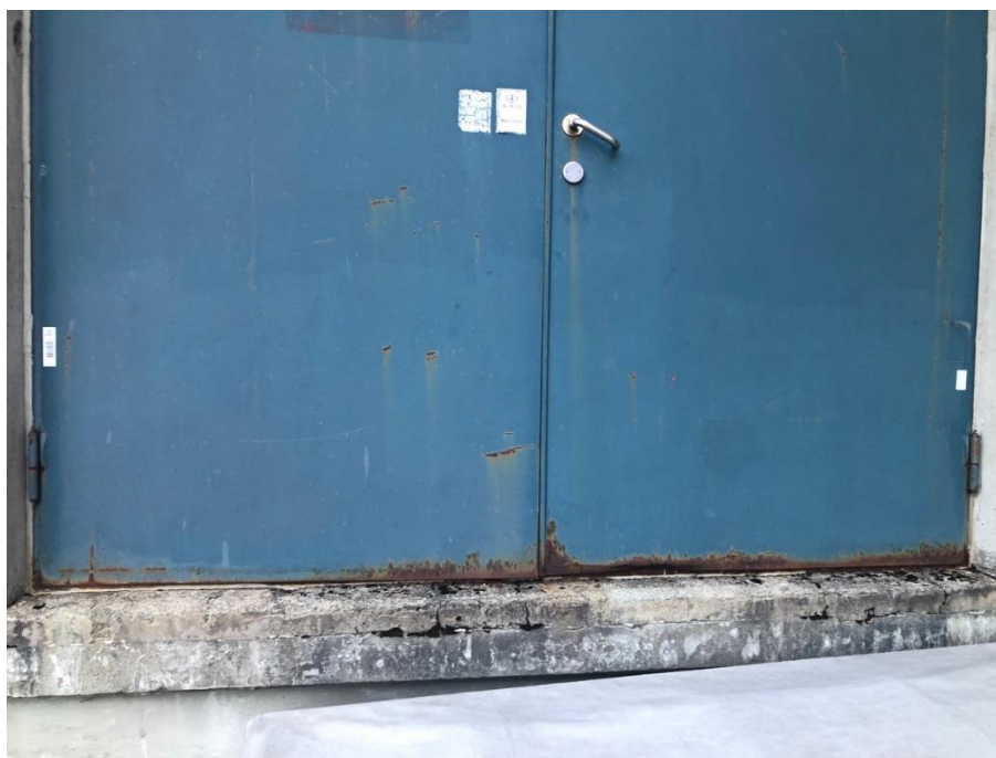
Bilde 14: Varelager galleri, korrosjonskadet ståldør
