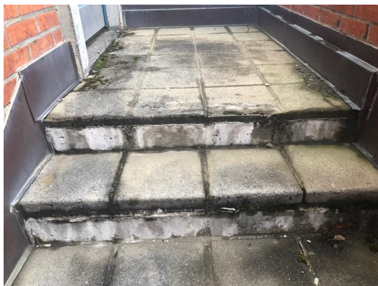
Bilde 16: Rømingstrapp fra bibliotek, skader på betongbeller
