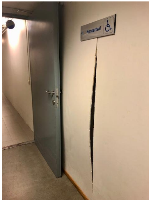
Bilde 17: Lettvegg i kjellergang er påført vertikal last pga setninger på yttervegg ved hovedinngang
