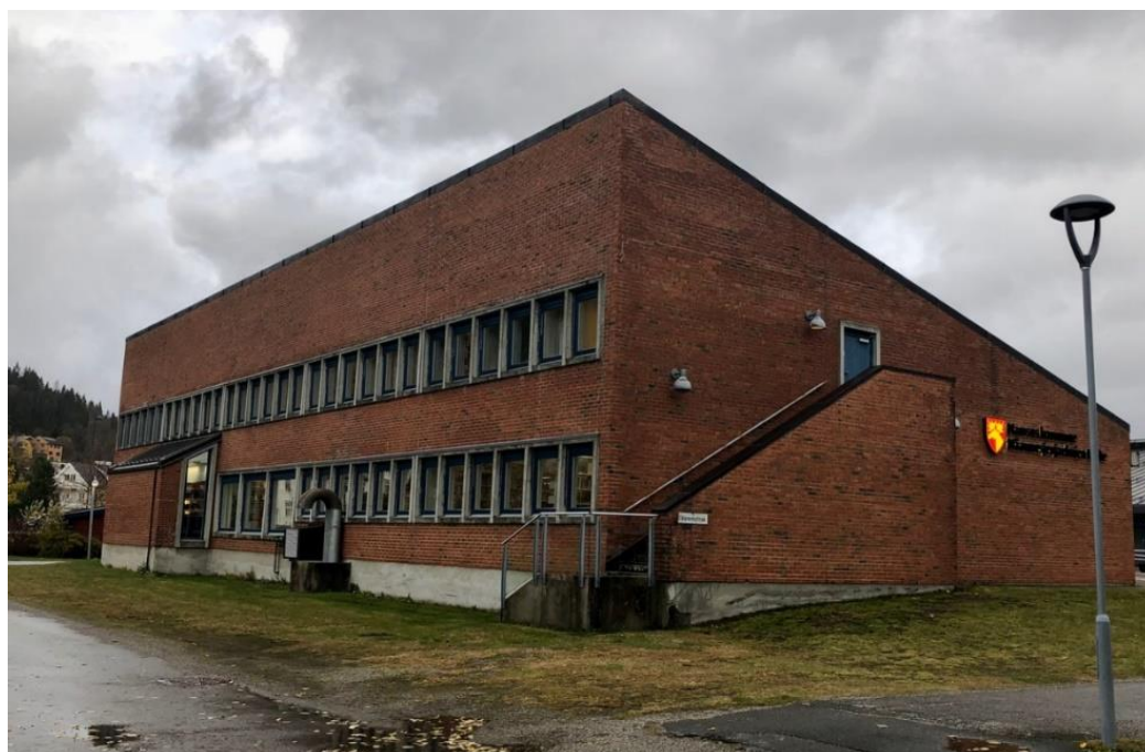
Bilde 10: Bibliotekfløya sett fra Stasjonsgata. Vestfasaden er impregnert for å hindre vanninntrengning
