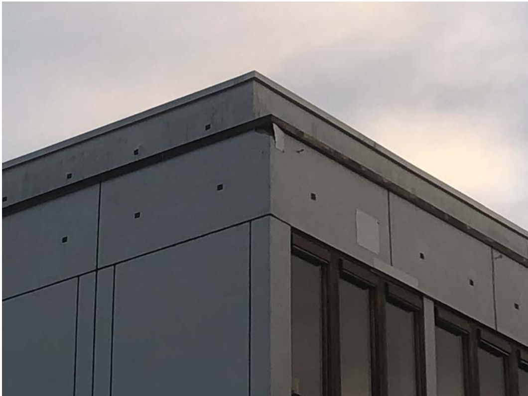
Løse partier i fasaden faller ut. Nødvendlikehold med påmonterte stålblater.
