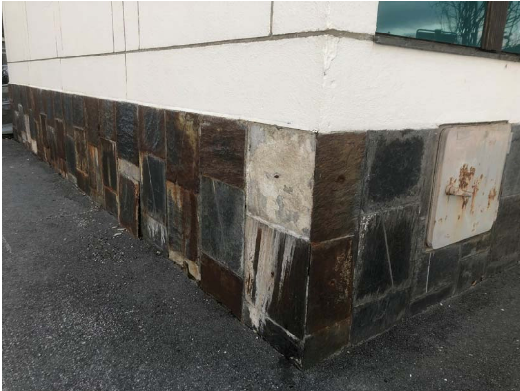
Skiferheller har over lengre tid løsnet og er blitt festet på nytt med bolter som nå delvis er rustet bort.
