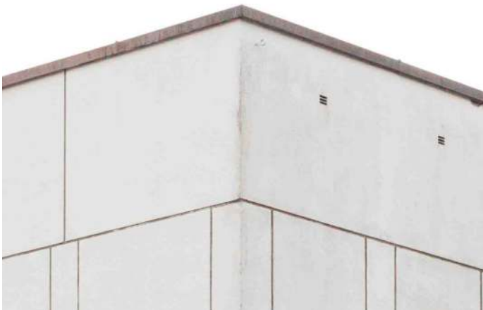
Svart belegg på parapeten og kvit puss på fasaden.
