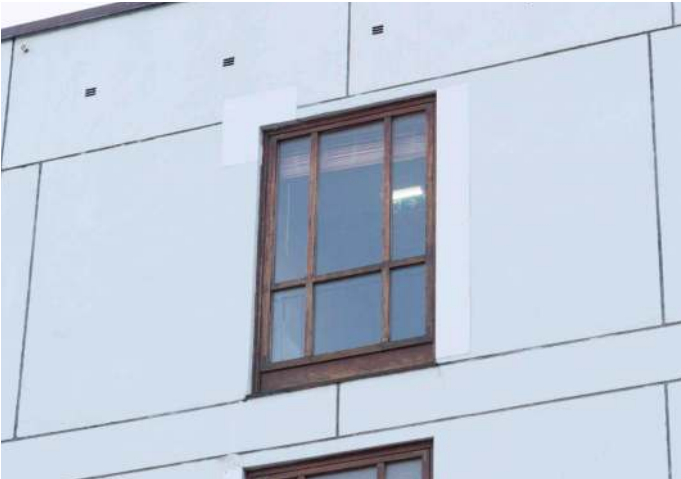
Betongskadar i fasaden er midlertidig fiksa med metallplater.
