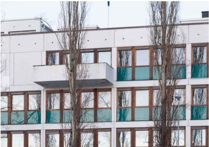
Ved etterisolering vil det vera problem med kuldebruer, blant anna her, ved balkongen i kontorfløya.
