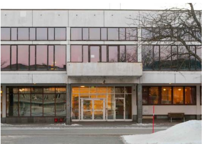
Vestfasaden har eldre vindauga som treng teknisk oppgradering.
