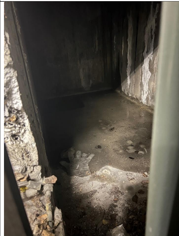
Bilde 36: Sjakt i traforom med vann på gulv.
