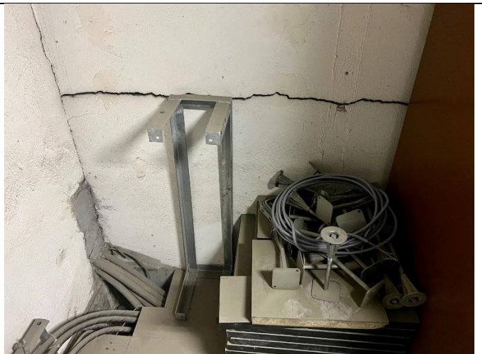
Bilde 37: Sprekk i innervegg mot verksted. Yttervegg mot Klingavegen til venstre.
