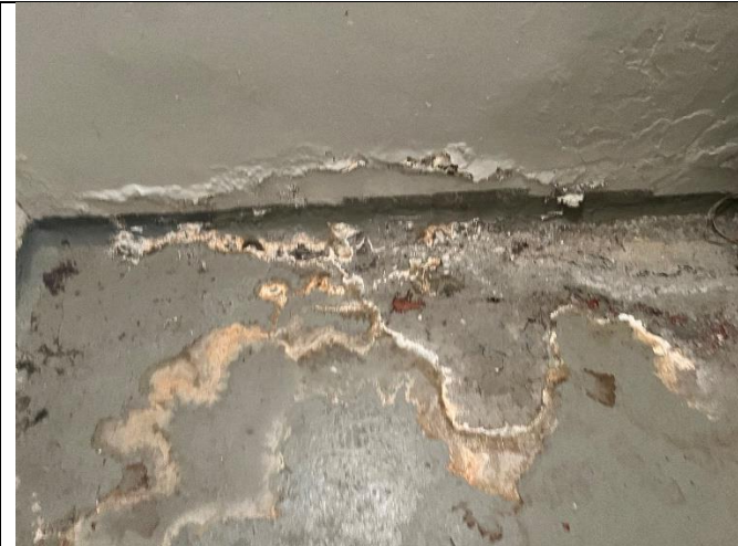
Bilde 34: Fuktinntrenging brystning mot Klingavegen.
