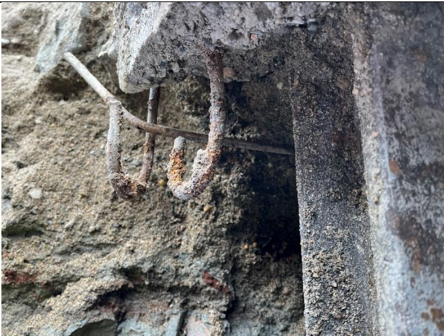
Bilde 8: P 2: Høyre pel i overgang pel grunnmur. En del frilagt og rusten armering/bøyler rundt.
