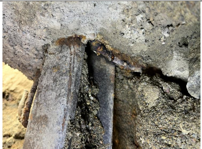
Bilde 9: P 2: Høyre pel overgang grunnmur sett fra bakside.
