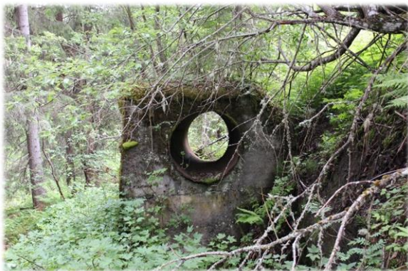
Deler av rørgata til Sævik kraftstasjon
